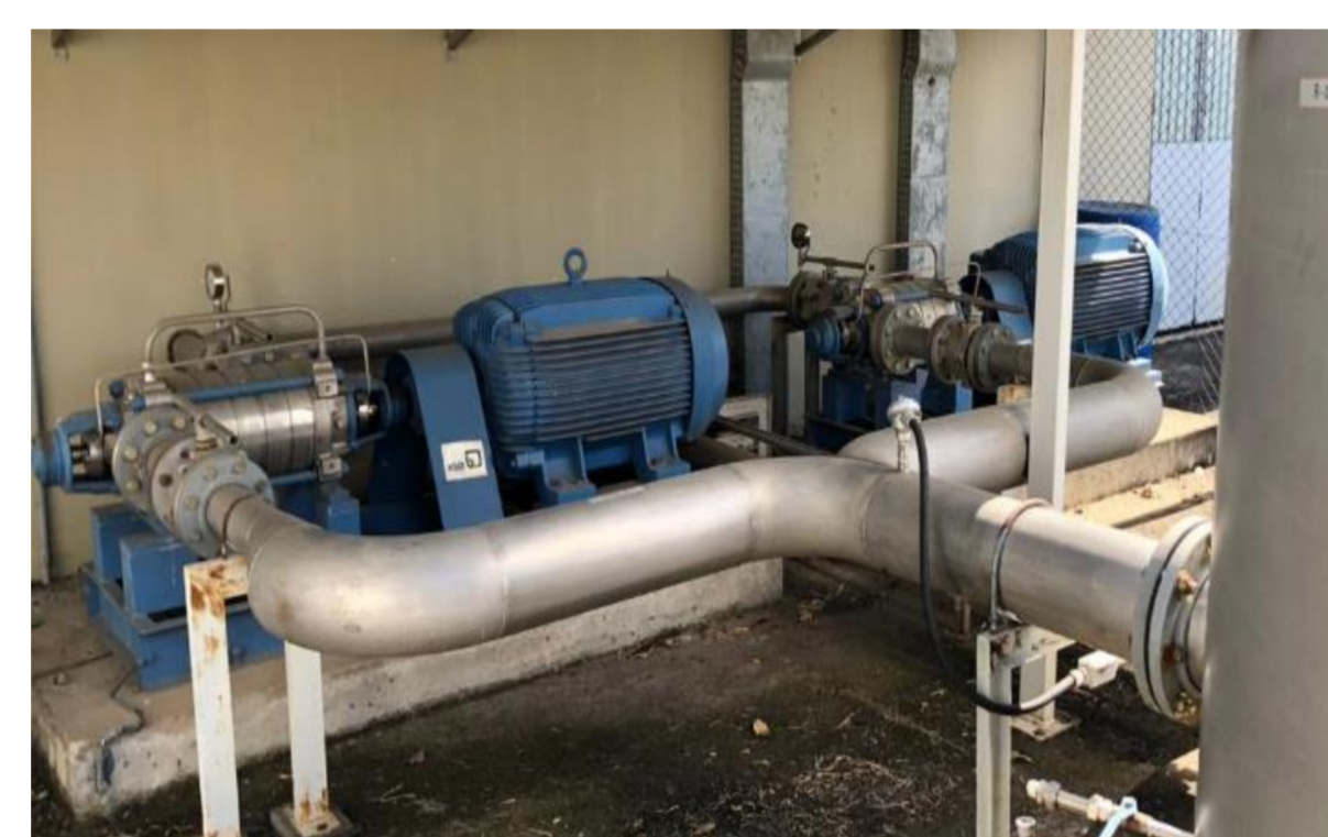
Figura 2 – Bombas de água de 175 e 250 HP-cv
